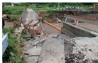
平成26年台風第8号の被災現場 (山形県南陽市白山在家地区) (内閣府提供)
