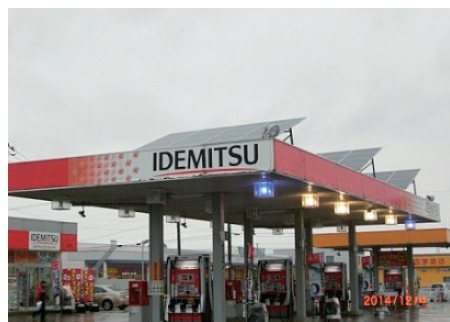
太陽電池モジュール設置状況①
